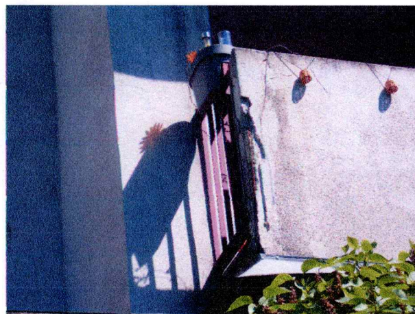
Balkony do remontu
