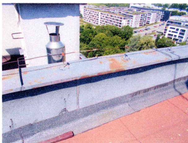
Ogniska korozji obróbek dachu
