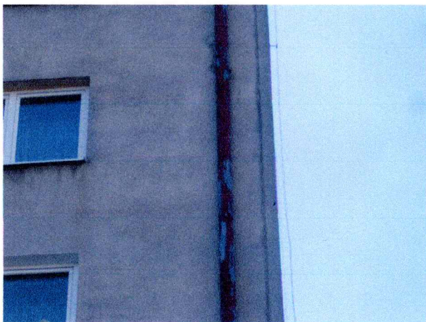
Złuszczenia powłoki malarskiej rury spustowej
