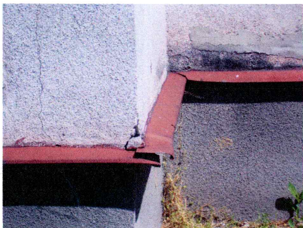
Obróbki elewacji do remontu/wymiany
