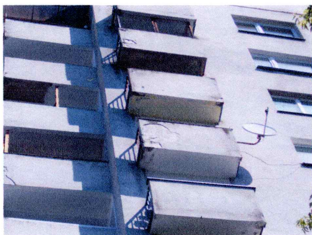
Balkony do remontu
