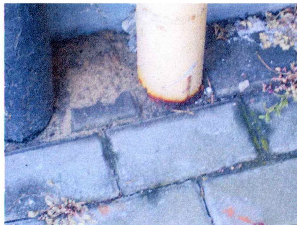
Korozja instalacji gazowej przy gruncie
