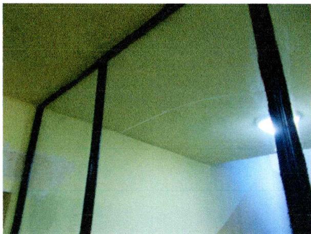
Pęknięta szyba na klatce
