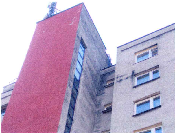
Przebarwienia i glony na elewacji
